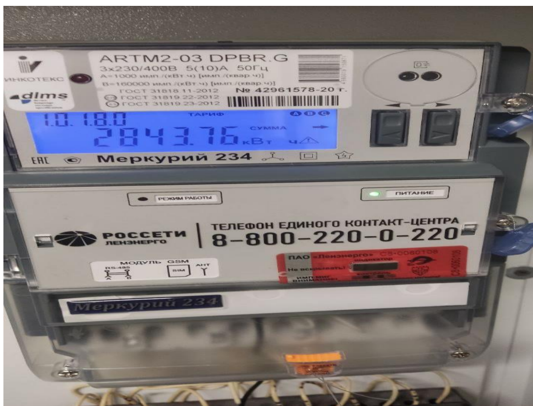
Рис.2. Узлы учета электроэнергии
